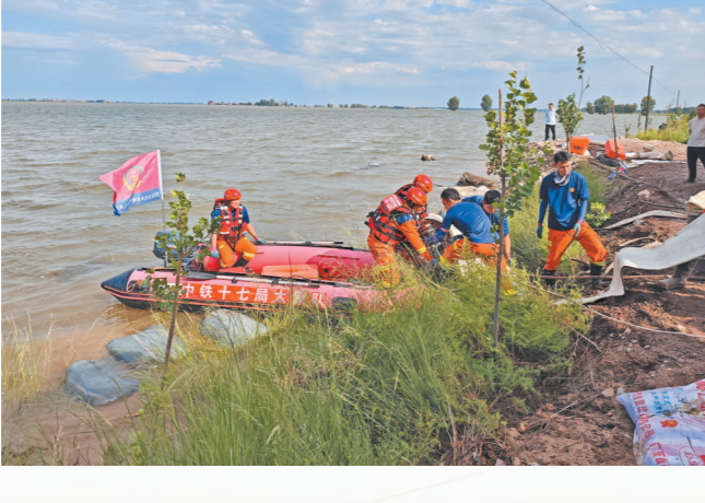
抢险队员跨越470公里抵运内蒙古自治区呼和浩特市托克托县双河镇开展排涝抢险。
