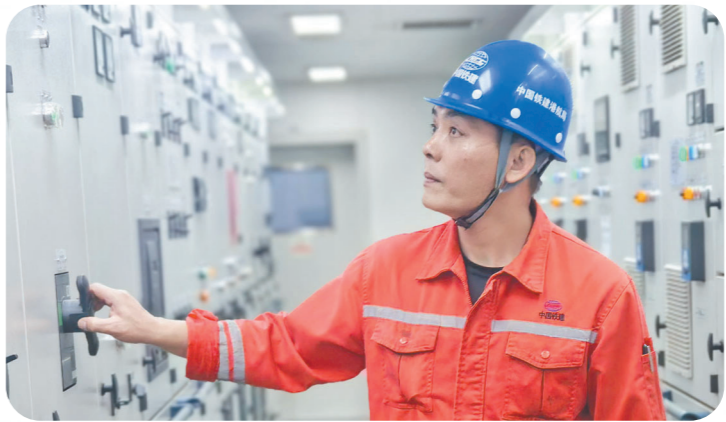
王小华在检查船机设备运行情况。 赵习州 摄
