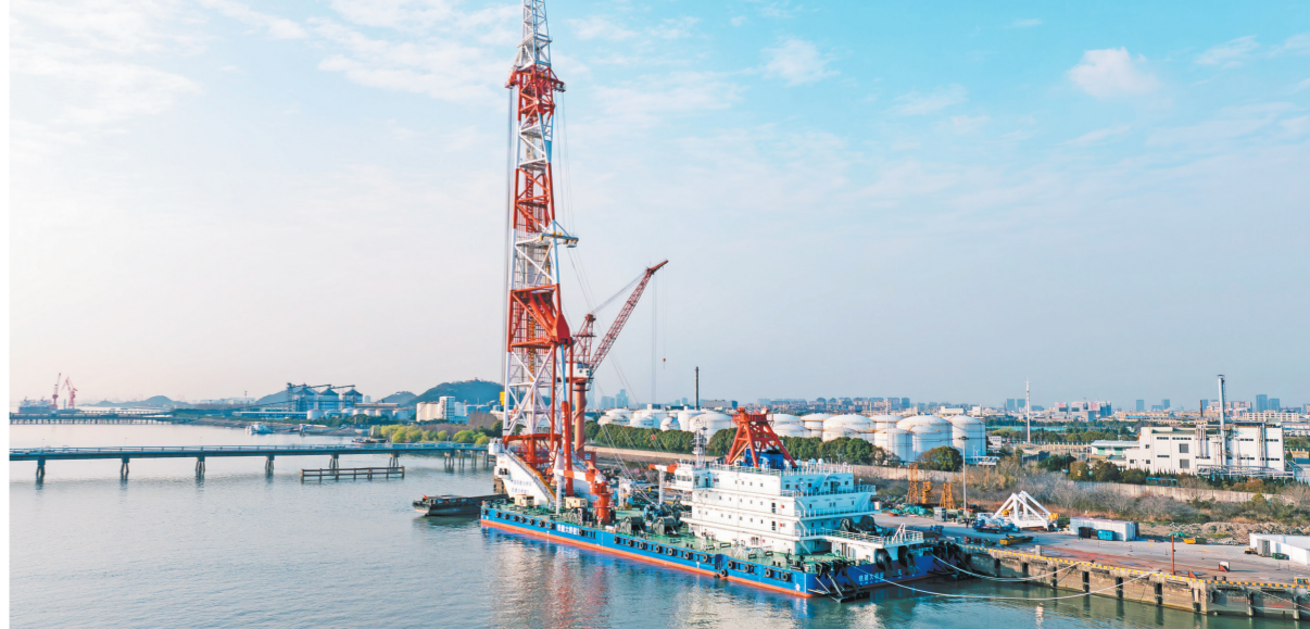
3月31日,由中国铁建大桥局投资建造的全球最大打桩船“铁建大桥1号”在江苏南通正式交付。作为拥有三项世界级性能指标的打桩船,该船总长130.5米,宽40.8米,桩架高度156米,可打直径7米、桩重700吨的桩基,作业水深最深可达70米,打桩定位精度实现厘米级。在技术研发上实现两大全球首创应用,核心部件实现自主研发,可满足全球海域施工要求。图为“铁建大桥1号”打桩船。
