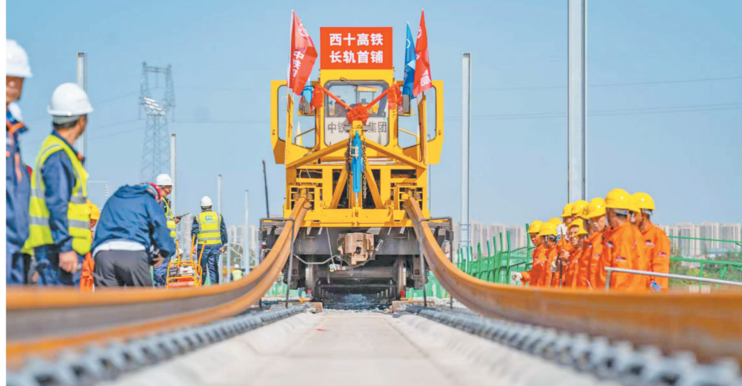
9月8日,随着首对500米长钢轨平稳精准铺设在沪河特大桥无砟轨道上,标志着由铁一院设计的西(安)十(堰)高铁正式进入全线铺轨阶段,为后期全线具备开通条件打下坚实基础。杨奇越 摄
