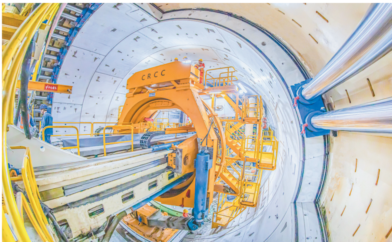
8月19日,随着“深江1号”盾构机顺利完成3590米既定掘进任务,由中铁十四局承建的深江铁路珠江口隧道抵达珠江口海底106米,这是中国大盾构水下掘进的最深纪录,也是世界高铁盾构隧道掘进的最深海底纪录。工程建成后,中国高铁将在百米海底飞驰。图为盾构机在进行管片拼装。范少文 摄
