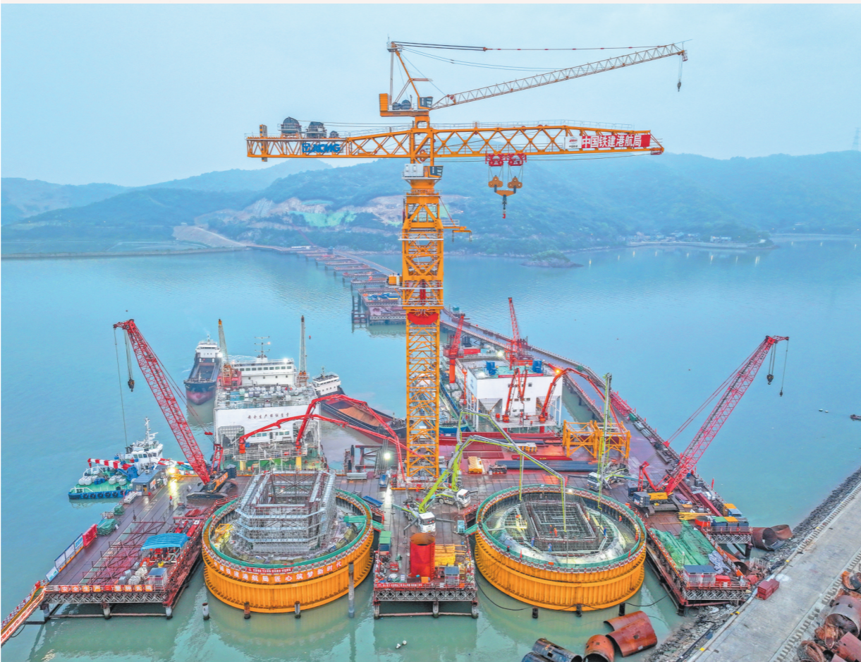
4月16日，由中国铁建大桥局、中国铁建港航局联合承建的双屿门大桥佛侧索塔承台完成浇筑，标志着国内最大跨度跨海桥主塔承台全部施工完成，即将进入塔柱施工阶段。双屿门大桥是世界级跨海连岛工程——宁波舟山港六横公路大桥二期的关键控制性工程。施工过程中，建设团队不断优化施工方案，对混凝土搅拌船补料环节、浇筑环节、收面环节等精细分工，确保承台浇筑的进度和质量。图为双屿门大桥海上承台浇筑。何加万 摄
