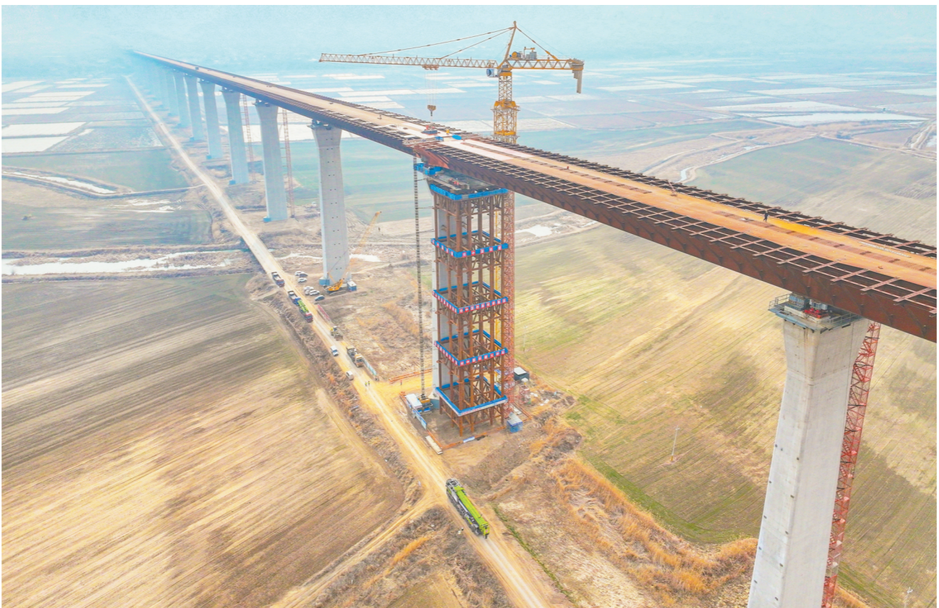
3月8日,由铁建投投资,中国铁建大桥局承建的临猗黄河大桥建设正加紧推进,建设者克服地质条件、桥位环境复杂,生态敏感等技术难点,全力冲刺年内通车目标。该大桥采用等高度连续钢箱组合梁工艺,创下连续顶推长度、最大顶推长度等四项世界第一。图为大桥建设现场。刘济伟 摄
