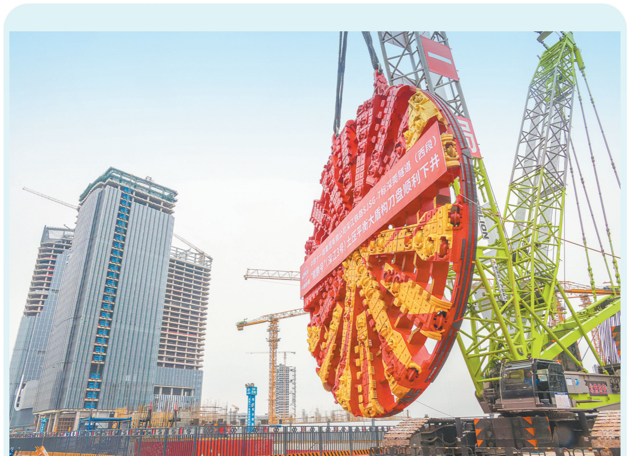
2月28日,在中铁十一局深江铁路全线控制性工程——深莞隧道(西段)施工现场,国内复合地层最大直径土压平衡盾构机“鲲鹏号”(深江3号)刀盘顺利吊装下井。深江铁路是我国“八纵八横”高铁网沿海通道的重要组成部分,也是重要的跨江城际通道,正线全长约116公里。图为“鲲鹏号”盾构机刀盘吊装现场。 闵辉摄
