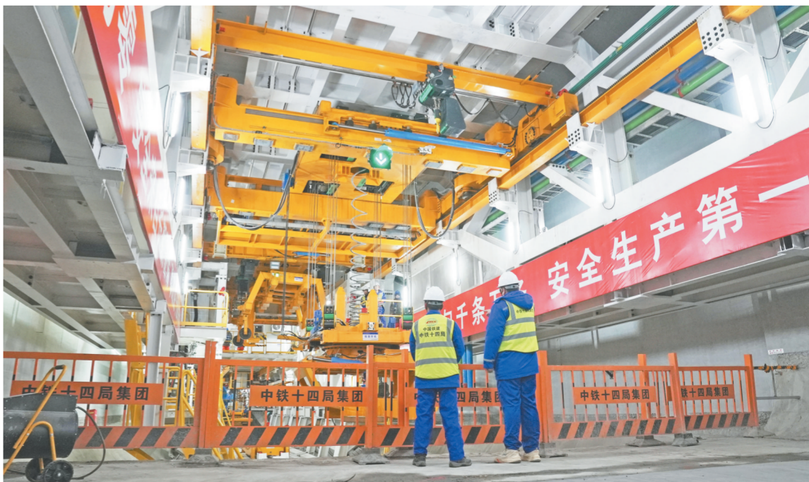
1月4日,在中铁十四局京唐城际铁路运潮减河隧道工程施工现场,开挖直径达13.3米的“京通号”国产超大直径泥水平衡盾构机正快速掘进。该盾构机是目前北京市最大直径铁路隧道盾构机,将用5个月时间掘进1285米,全力冲刺今年6月全线贯通目标。图为京唐城际铁路盾构机操作人员正在检查箱顶设备。 钟行利摄
