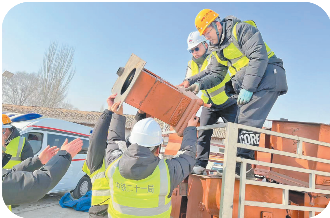
12月18日23时59分,甘肃临夏州积石山县发生6.2级地震。地震发生后,中铁二十一局积石山县大何家项目部第一时间组织所属人员撤离至安全地带,并协助当地应急救援队伍疏通道路、拆除危墙、转移受灾群众。图为12月19日早上,该集团项目职工全力协助属地政府搬运方便面、矿泉水、炉子等救援物资。
