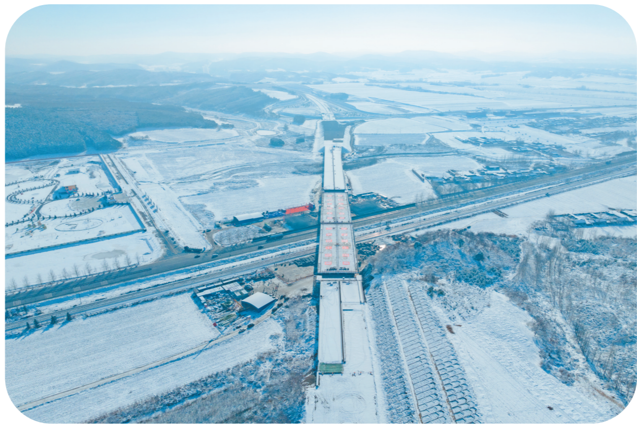
11月14日,由中铁十四局承建的长春经济圈环线高速公路转体桥成功转体。该桥梁主跨达108米,桥体宽度29.6米,梁体重量达2.92万吨,是吉林省首座同时跨铁路、公路的大跨度、大坡度、大重量公路转体桥梁。 图为转体成功后的长春经济圈环线高速公路桥。 李祯林 摄
