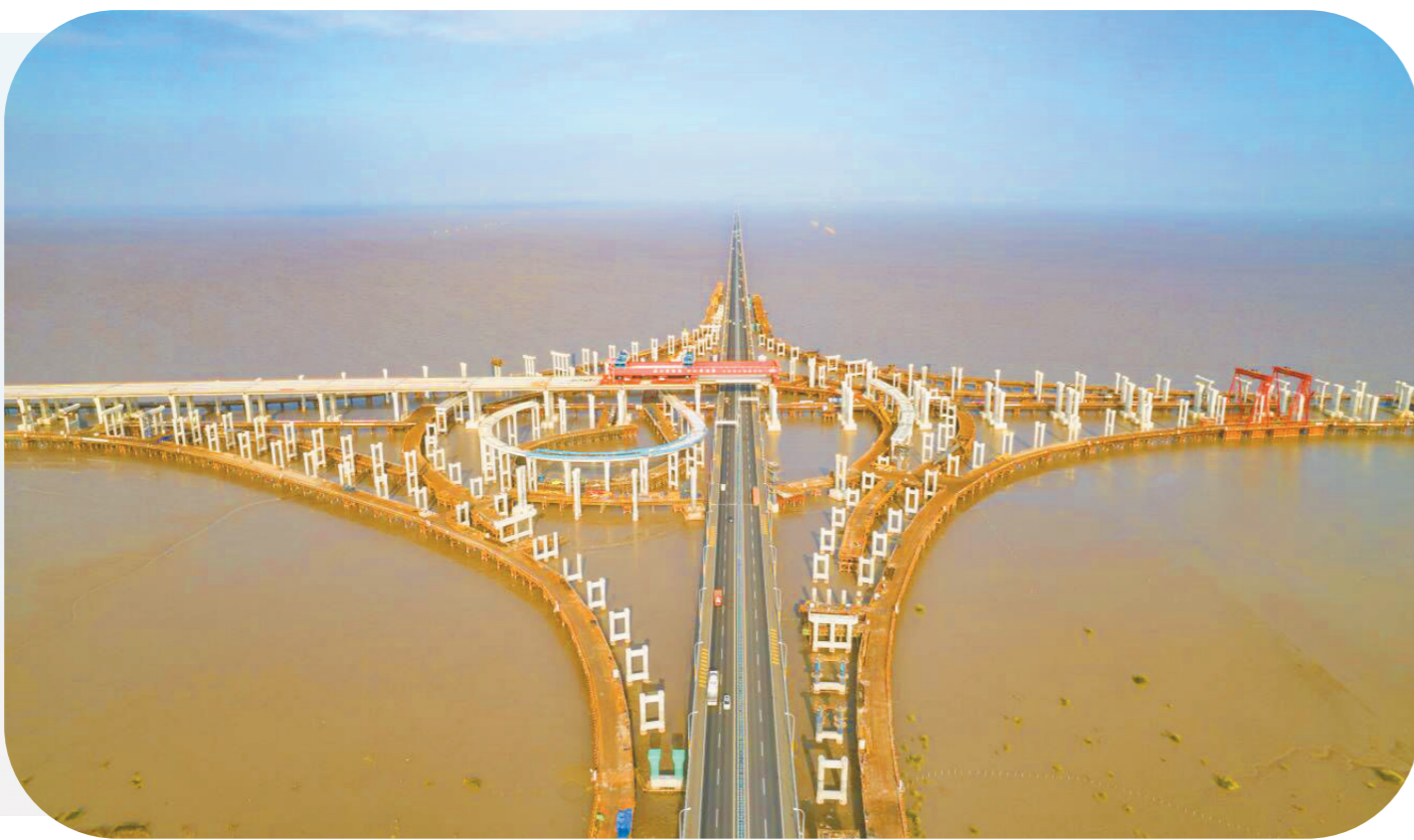
11月3日，由中铁十六局负责架梁施工的亚洲最大海上互通——滨海互通主线桥顺利完成上跨金塘大桥架梁施工，为杭甬复线宁波一期项目全线贯通奠定了坚实基础。其中，项目架设的长50米整孔预制箱梁重达1800吨，是目前国内梁上运梁单体最重的整孔预制箱梁。图为上跨金塘大桥架梁施工现场。 赵启摄
