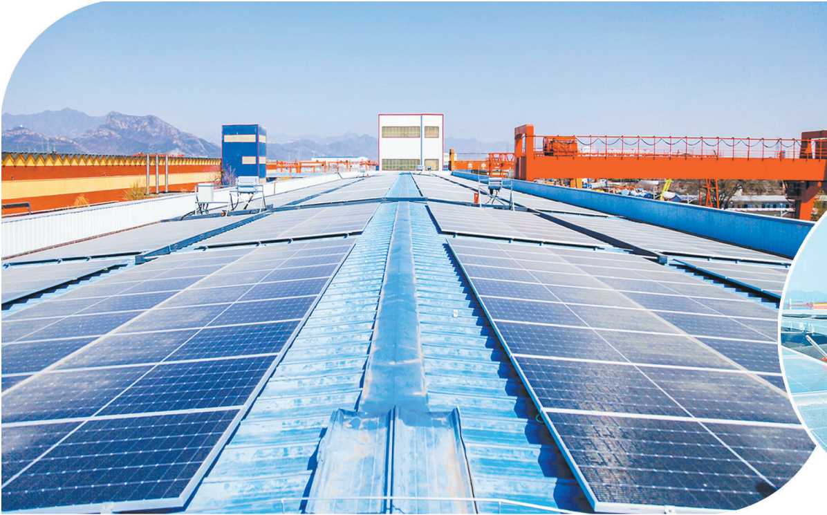
图为竣工后的房桥光伏工程。
