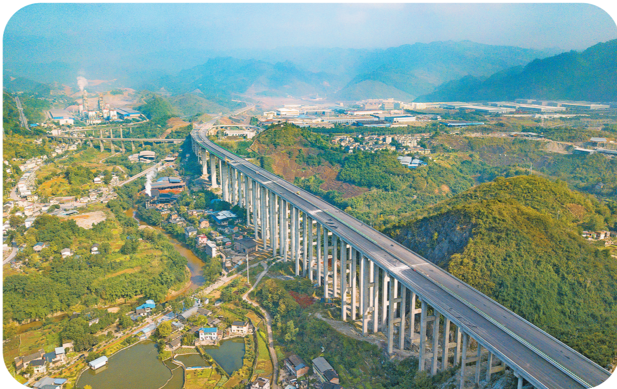
12月7日,由中国铁建昆仑投资集团重庆投资参与投资建设的渝黔高速扩能项目进入通车冲刺阶段,目前该项目主体工程已完工,全线进入交安、机电安装及收尾施工阶段,预计今年12月底正式开通运营。重庆渝黔高速公路扩能项目全长约100公里,双向六车道,建成后将与渝黔高速一并构成重庆向南经贵州直达广西的出海高速“双通道”。图为全线里程最长的温塘村特大桥正在进行桥梁较缝施工。
