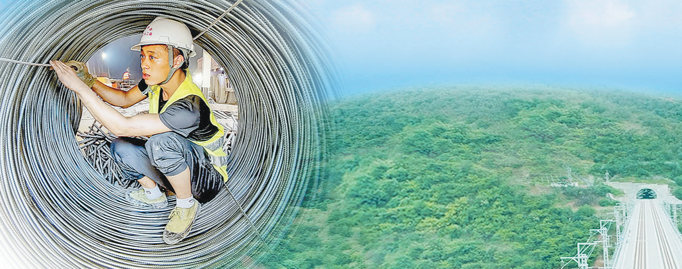
中老铁二十局建设者在洞内绑扎隧道衬砌钢筋。 唐海洋 摄
