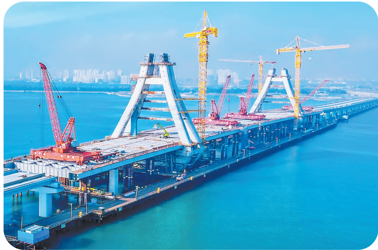
由中铁二十局三公司承建的广西北海市西村港跨海大桥全长2544米,其中跨海桥梁总长1776米,设计为双向6车道,主塔采用国内罕见的大倾角空间索塔,造型来源于北海市出土的西汉文物铜风灯,铜风造型的塔塔配以如同弦琴的拉索,主塔凸显“风冠琴韵”,独具魅力,为全国首创。图为11月15日,大桥正在进行钢架架梁施工,确保本月底大桥贯通。 陈福得 摄
