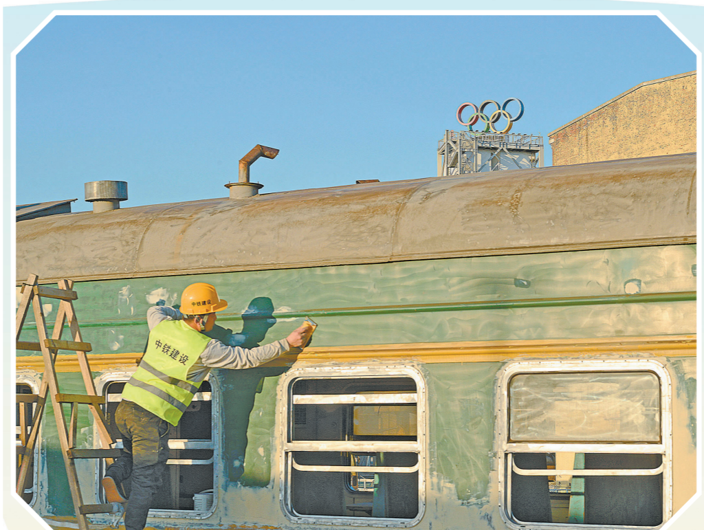
日前,由中铁建设装饰公司参建的北京冬奥公园“火车乐园”景点正在进行开园前的最后冲刺。北京冬奥公园紧邻2022年北京冬奥组委驻地首钢滑雪大跳台,是首都西部最大的城市休闲公园。图为建设者对火车进行翻新处理。
