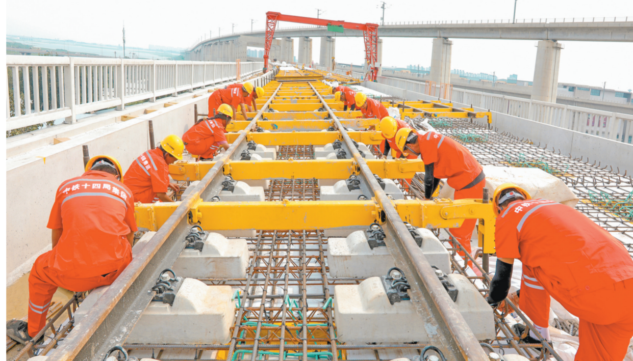
近日,随着京广特大桥首段无砟轨道道床浇筑完成,北京丰台站改建工程无砟轨道正式开始施工,为年底实现通车运营打下坚实基础。丰台站改建工程是我国首座采用高速、普速客运车场重叠布置的大型客站,建成后将对优化首都交通结构,完善首都综合交通体系,带动社会经济发展都将起到重要作用。图为中铁十四局建设者在进行Ⅰ型双块式无砟轨道道床钢筋绑扎。冯冬秋 摄
