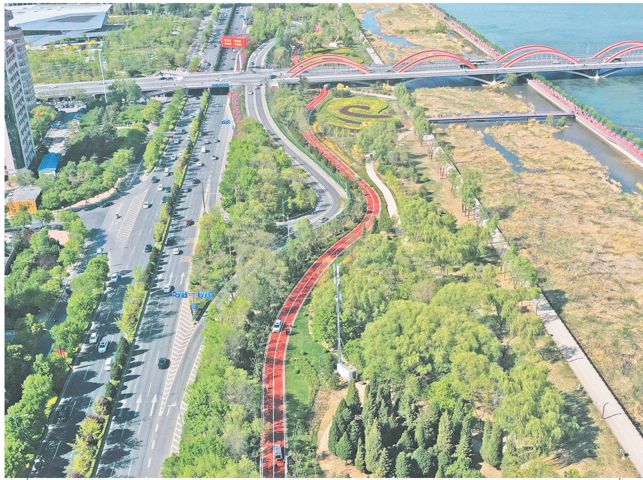
经过8个月紧张施工,日前,由中铁十二局承建的山西太原滨河自行车专用道工程第五标段顺利完工,成为市民骑行、观景的好去处,对构建汾河廊道多元交通体系起到积极推动作用。该标段位于汾河西岸,北起漪汾桥,南至南内环桥,全长4.01公里。图为太原滨河自行车专用道下穿漪汾桥。 赵桂军 摄
