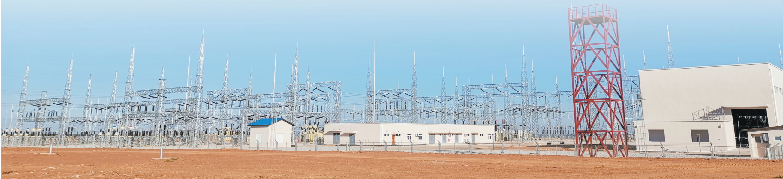
中铁十七局电气化公司参建的赞比亚米皮卡变电站项目
