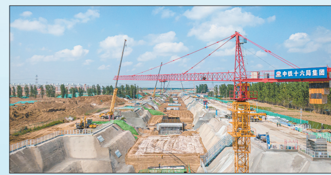
中铁十六局承建的雄安新区启动区内NA9市政道路、NA11市政道路及相关综合管廊、给排水管网系统、燃气、热力等市政基础设施工程,是启动区首个开工项目。建成后将为雄安新区启动区发展提供骨干路网支撑。图为4月30日,NA11道路管廊主体结构施工大干现场。陈悦 摄
