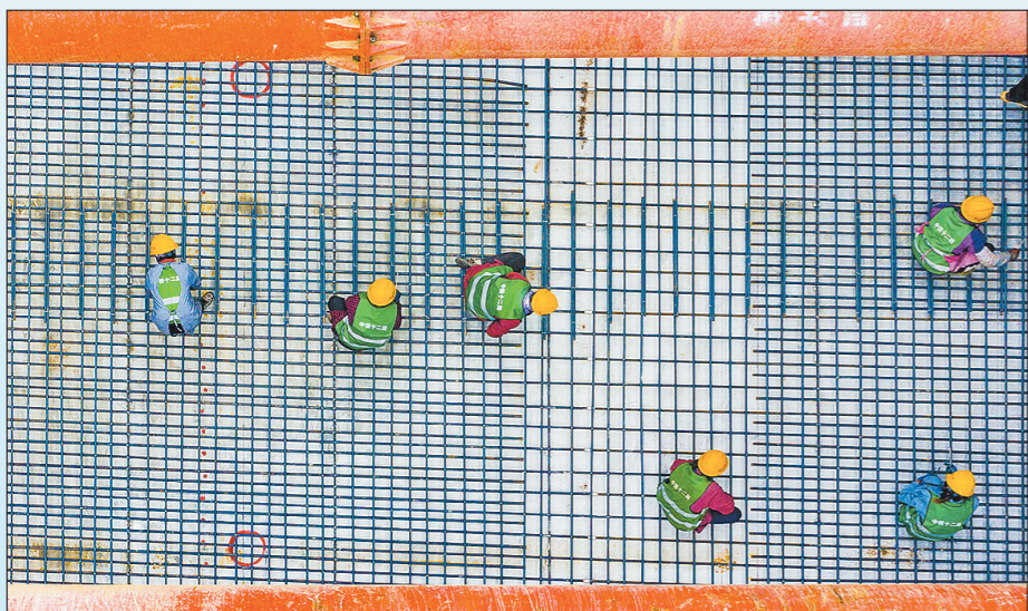
由中铁十二局承建的雄安新区枢纽片区市政道路、综合管廊、排水管网系统(一期)工程,综合运用数字雄安建设管理平台、BIM智慧管理平台、生产进度管理系统“两平台一系统”强化现场安全、质量和进度管理。图为4月22日,建设者正在进行综合管廊底板钢筋绑扎。金伟 摄
