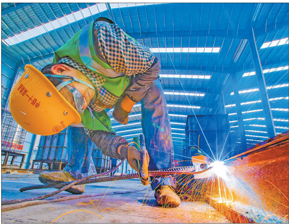
中铁十一局担负着雄安新区容东DEG社区内21787米的组合管排预制任务,建设者在施工中创新采用三道“井字型”辅助支架,有效避免了CPVC管的错位、浮管、移位等一系列问题,极大提高了工作效率,确保了产品质量。图为4月25日,建设者正在进行预制台座钢板焊接。金伟 摄
