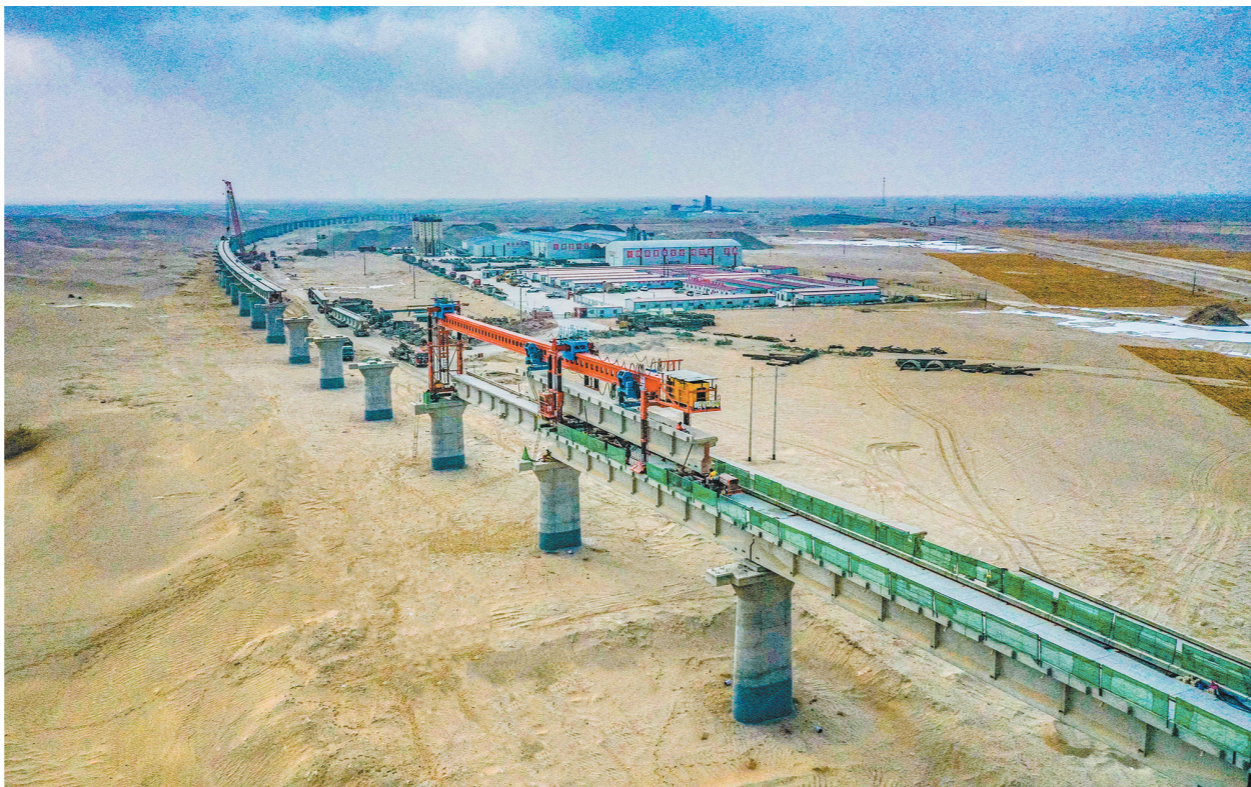
近日，全长9.8公里的新疆和(田)若(羌)铁路亚古孜特大桥架梁完成。和若铁路穿越塔克拉玛干沙漠无人区，全长825公里，是环塔里木盆地铁路网的重要组成部分，建成后沿线5个县将结束不通火车的历史。中铁十四局建设者克服缺水、严寒、高温、沙尘暴频繁、物资紧缺、运输不便等困难，创造了日架梁6片T梁的纪录。图为架梁施工现场。 范少文 摄
