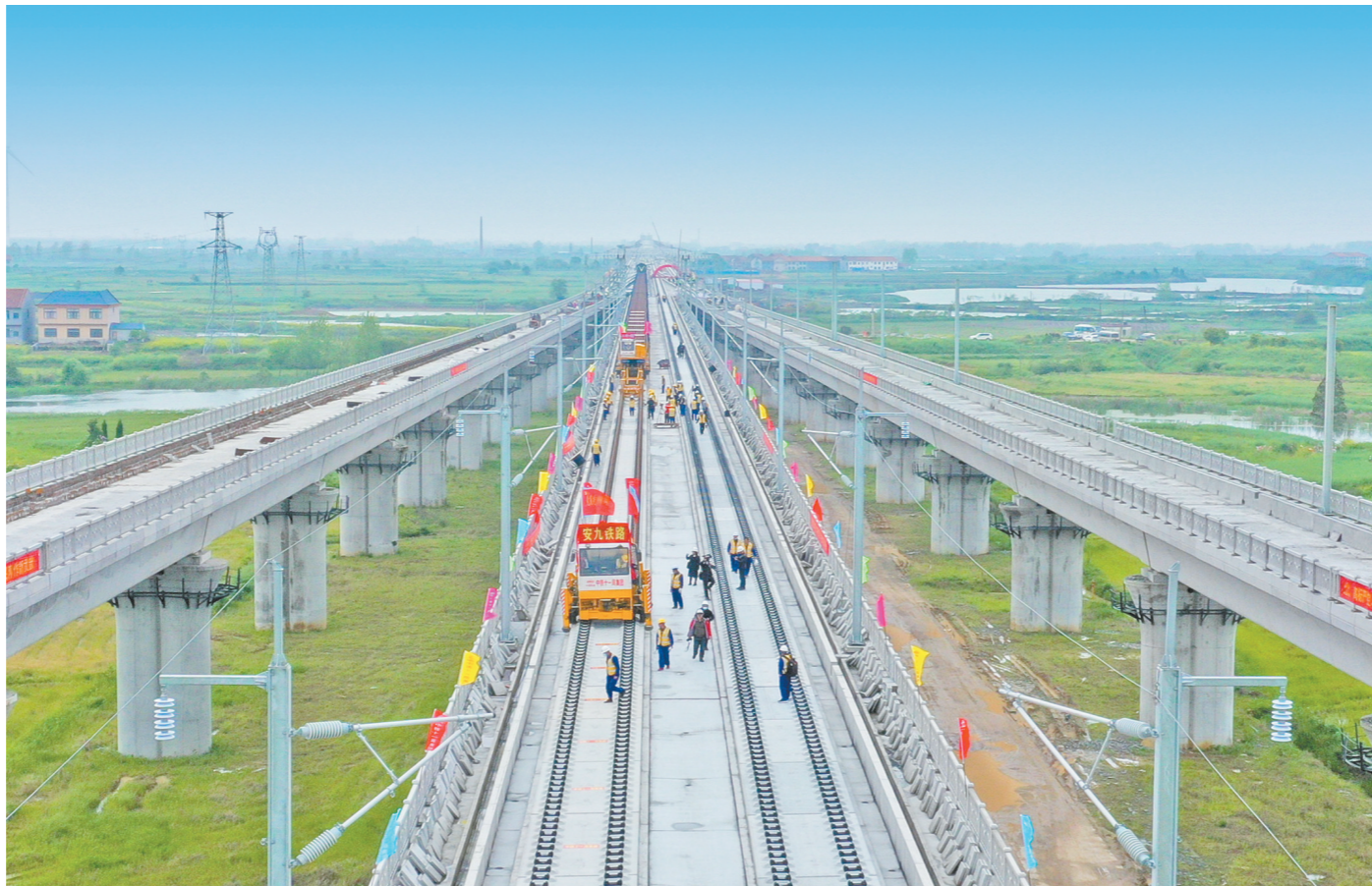
4月8日,由中铁十一局、中铁十二局等单位参建的安九高铁湖北段开始铺轨。作为京港高铁的重要组成部分,安九高铁建成后,将形成一条位于河南、安徽、江西三省境内的南北向大运力、快速的客运通道。图为施工工人正在铺设首对500米长钢轨。 彭 特 摄
