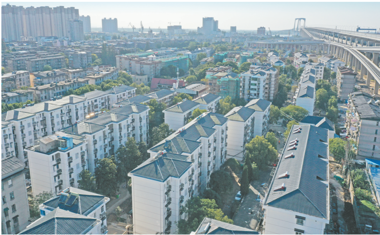
日前,由中铁十四局承建的安徽省在建体量最大的老旧小区改造项目——芜湖市绿影新村老旧小区改造施工进入收官阶段。该小区占地约140亩,主要施工内容是对小区内的61栋住宅楼和1座社区办公楼进行深度改造。改造完成后,将极大改善当地群众的居住条件,惠及小区2600余户居民。图为即将改造完成的绿影新村小区。 王观生 摄
