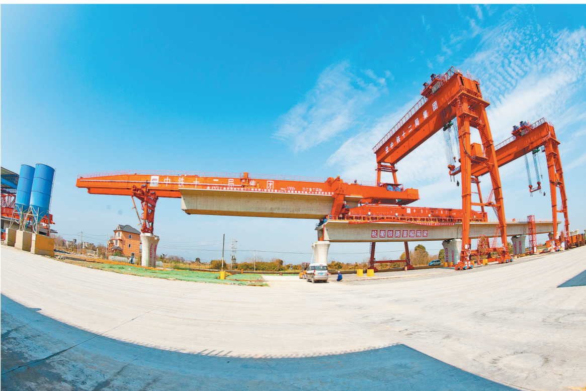
1月21日上午10时,由中铁十一局汉江重工研制的40米1000吨级高效型架桥机亮相中铁十二局抗衡高铁工地。据了解,中铁十一局汉江重工研制的40米1000吨级高效架桥机,目前已生产及使用25台(套),占国内市场的74%,稳居全国第一。图为40米1000吨级高效架桥机在进行架梁作业。 黄跃勇 摄
