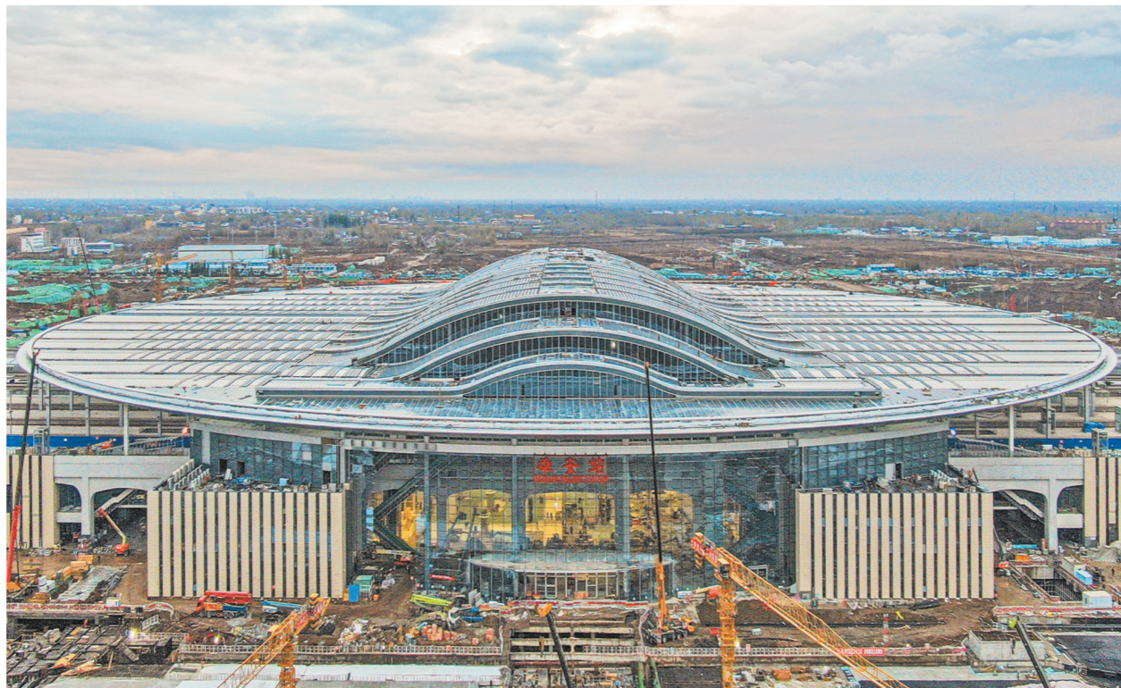
日前,中铁十二局承建的京雄城际铁路雄安站主体结构已封顶,内部装修及安装工程全面展开,预计今年底投入使用。据了解,雄安站目前有6000多名建设者昼夜奋战,进行内部装修和机电安装,全力确保今年底通车,届时京雄城际铁路也将同步开通。
