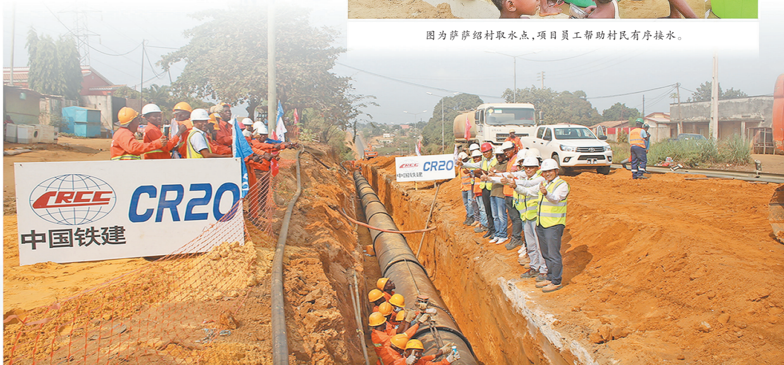
图为项目员工正在铺设卡宾达供水工程DN1000输水主管道。
