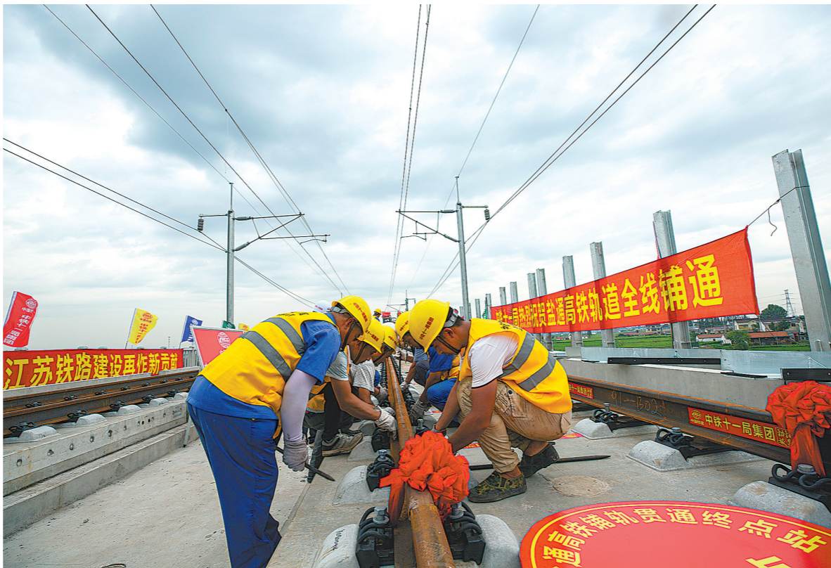
8月7日,在盐(城)(南)通高铁海安特大桥和南通西站外,随着中铁十一局建设者分别将一组钢轨铺设完成,标志着我国“八纵八横”高铁网沿海通道的重要组成部分——盐通高铁全线钢轨铺设完成。盐通高铁正线全长约156.6公里,中铁十一局三公司主要承担全线轨道铺设及115组新道岔铺设任务。图为施工人员正在安装轨道扣件。 彭特摄
