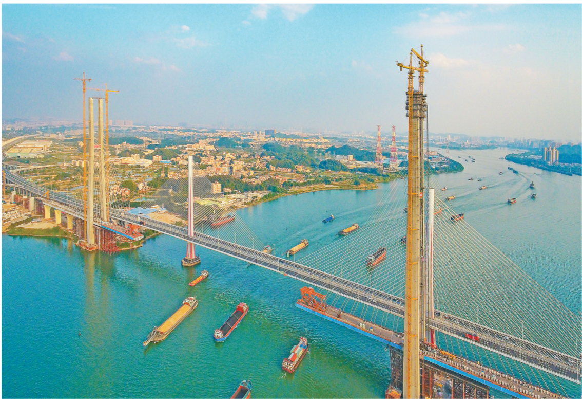
日前,由中铁十一局承建的粤港澳大湾区重点工程——广州南沙港铁路跨西江斜拉桥156号主塔顺利封顶。至此,该桥两座主塔全部封顶,正加快推进上部结构施工。南沙港铁路跨西江斜拉桥全长1117.5米,属钢箱混合双主梁结构,塔高超过200米,主跨跨径为600米,是世界双线货运铁路建设史上同类型结构跨度最大的斜拉桥。
