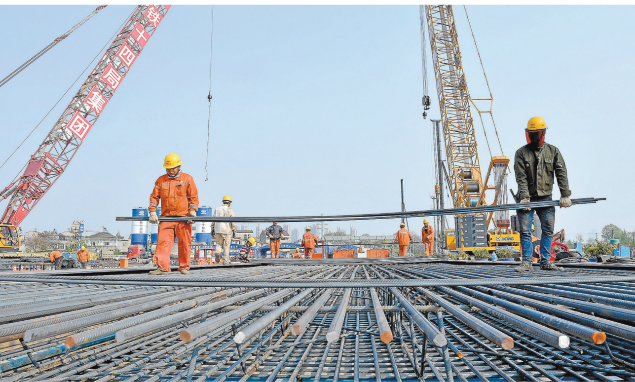
日前,由中铁十四局大盾构公司施工的南京建宁西路过江隧道开工建设。该工程盾构段长2349米,开挖直径15米,计划2025年建成通车,可有效缓解南京长江大桥交通压力。 刘福昌 摄
