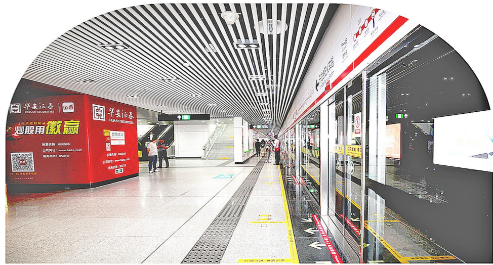
合肥地铁照明系统
