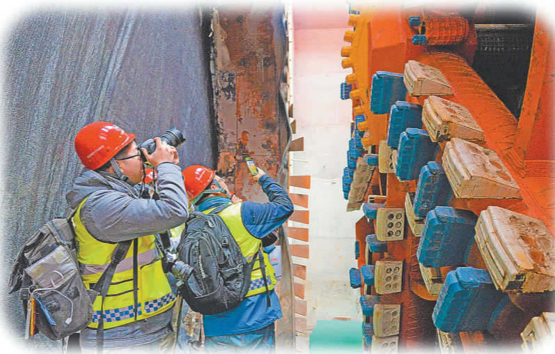
近日,在中国铁建、新浪微博组织下,20余位知名新媒体人和网友组成“微博神探团”,了解中国铁建地铁建设高科技。图为他们参观将穿越“四铁三河两桥一文物”等风险源的中铁十四局北京地铁19号线盾构机刀盘。曹睿摄
