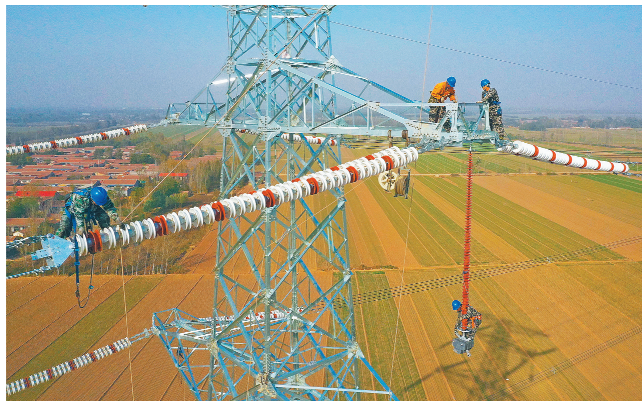
11月11日,经过168小时带电运行,由中铁十四局电气化公司负责施工的山东省东阿高速公路首条双回路500千伏超高压线路——柴胡线、聊韶II线运行高效平稳,为下游用户用电提供了保障。图为施工人员正在进行电力迁改作业。 范成涛 摄
