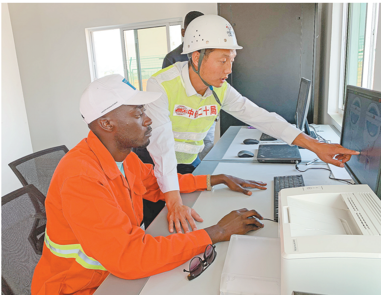
中铁二十局采用EPC模式建设的安哥拉托供水工程,是安哥拉比耶省目前最大最完善的供水项目。该工程交付运营以来,中铁二十局除负责水厂正常运营维护工作之外,还肩负起比耶省自来水公司员工的上岗培训任务。图为11月9日,中方项目技术人员指导安哥拉自来水公司员工熟悉中控操作流程。
