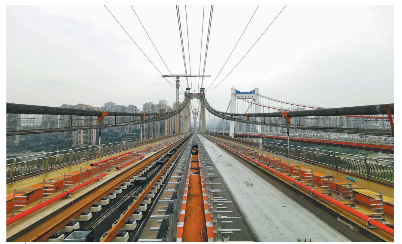
8月3日,重庆轨道交通环线二期实现全线贯通。中铁十五局在承建的鹅公岩轨道专用桥施工中采用的技术应用创多项国内第一,其中轻荷载隔高式减振整体道床施工技术和梁端及钢轨伸缩调节一体化装置都是国内首次应用。图为重庆轨道交通环线鹅公岩轨道专用桥施工现场。 晋文涛 摄
