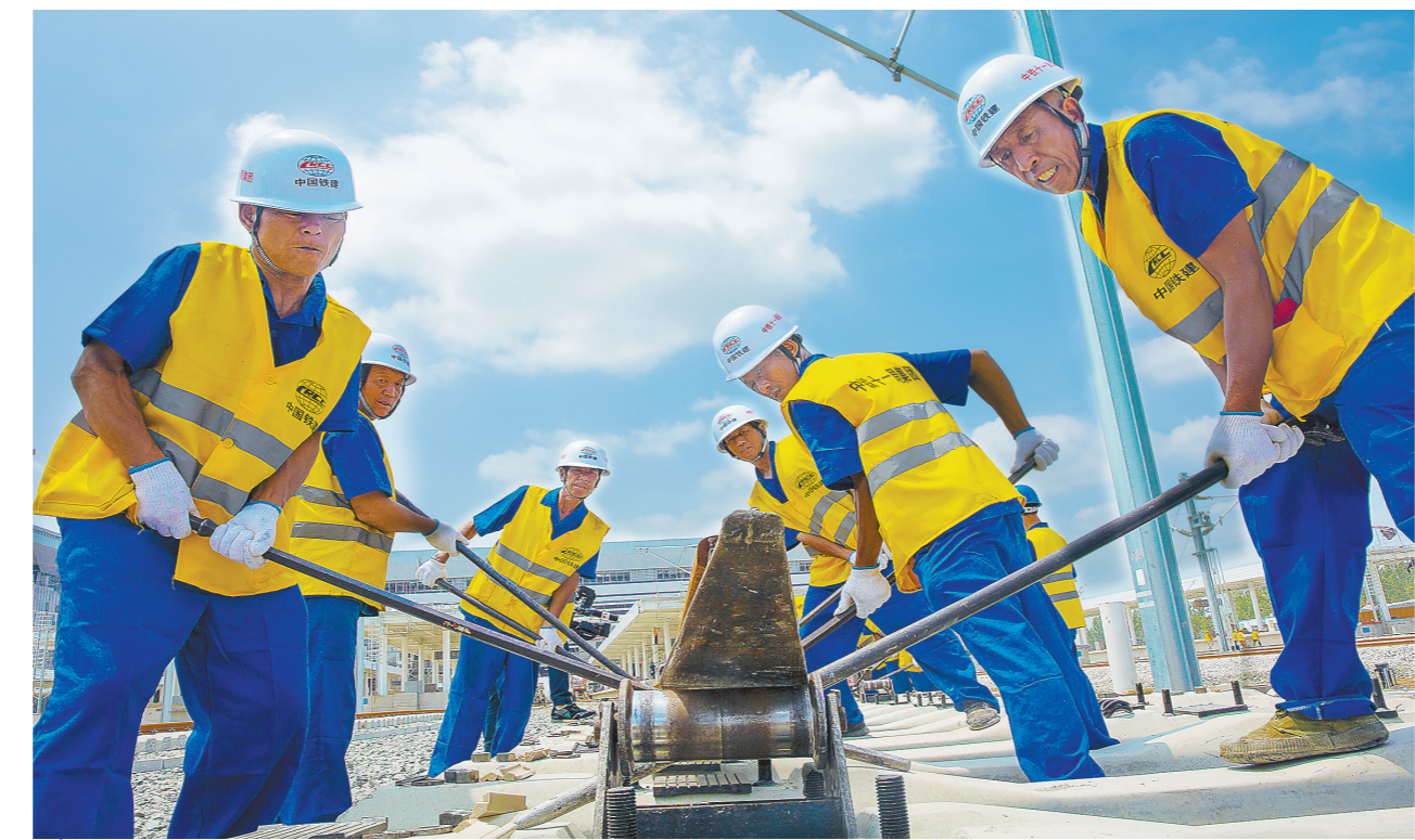
7月24日,由中铁十一局等单位建设的我国华东地区第二条快速客运通道——商合杭高铁合肥至商丘段铺轨完成。该高铁全长约794.55公里,设计时速350公里,预计2020年全线开通运营。届时,杭州至商丘将由11个小时缩短至4个小时左右。图为作业人员正在铺设最后一组500米长轨。 彭特摄
