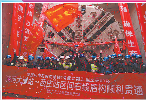
中铁十九局施工人员庆祝石家庄地铁1号线二期区间盾构贯通
