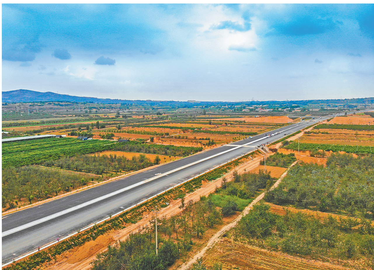
黄(龙)蒲(城)高速公路全长80.09公里,是陕西省交通规划主骨架网“六纵五横”中的主要组成部分,对陕西省实现“县县通高速”目标具有重要意义。为助力沿线的黄龙、洛川尽早实现致富,中铁二十局在建设过程中充分整合资源,加快施工进度,全力冲刺通车目标。图为黄蒲高速公路蒲城至白水段率先完成路基基层沥青摊铺。 宋永钊 摄
