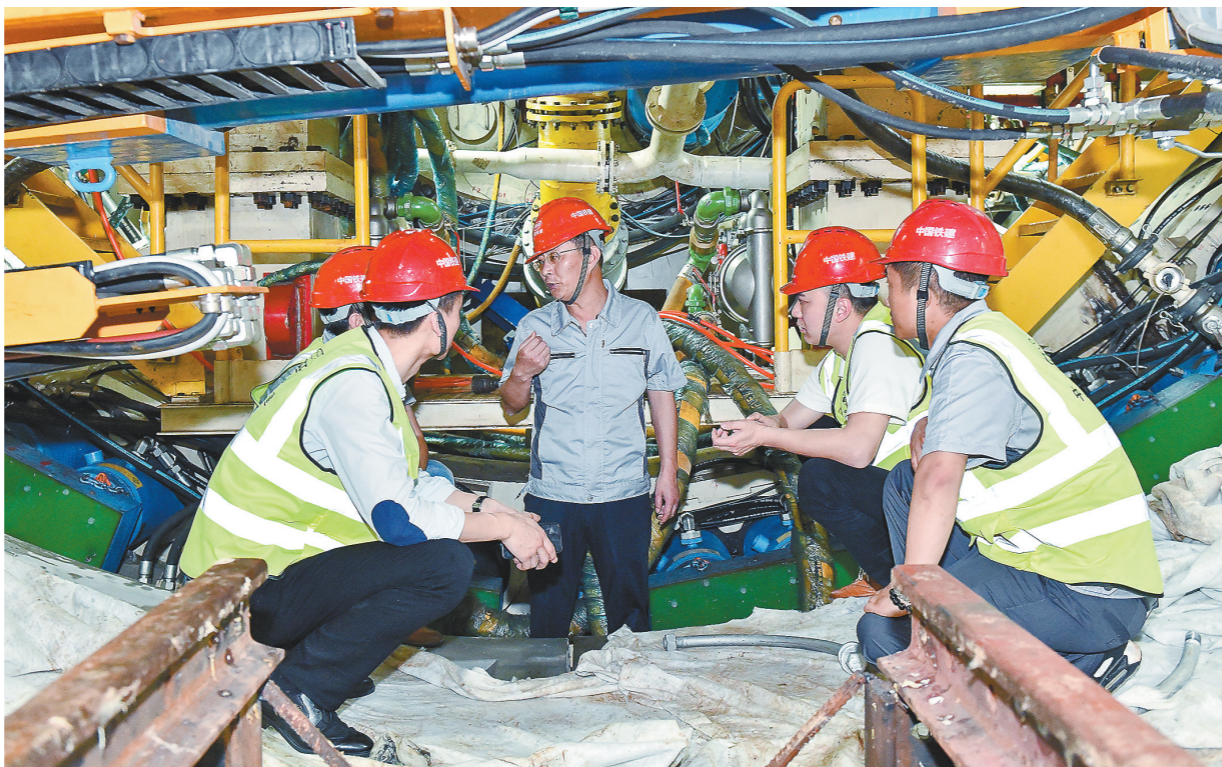
日前,由中铁二十二局轨道交通公司施工的广州地铁18号线和22号线项目首台大直径泥水盾构机顺利始发。图为项目经理马杰将安全课堂带到施工现场,为一线盾构施工技术人员讲解盾构掘进中的安全注意事项。 桂天奇 摄
