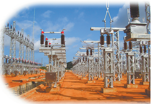
安哥拉毛鲁本托变电站。
