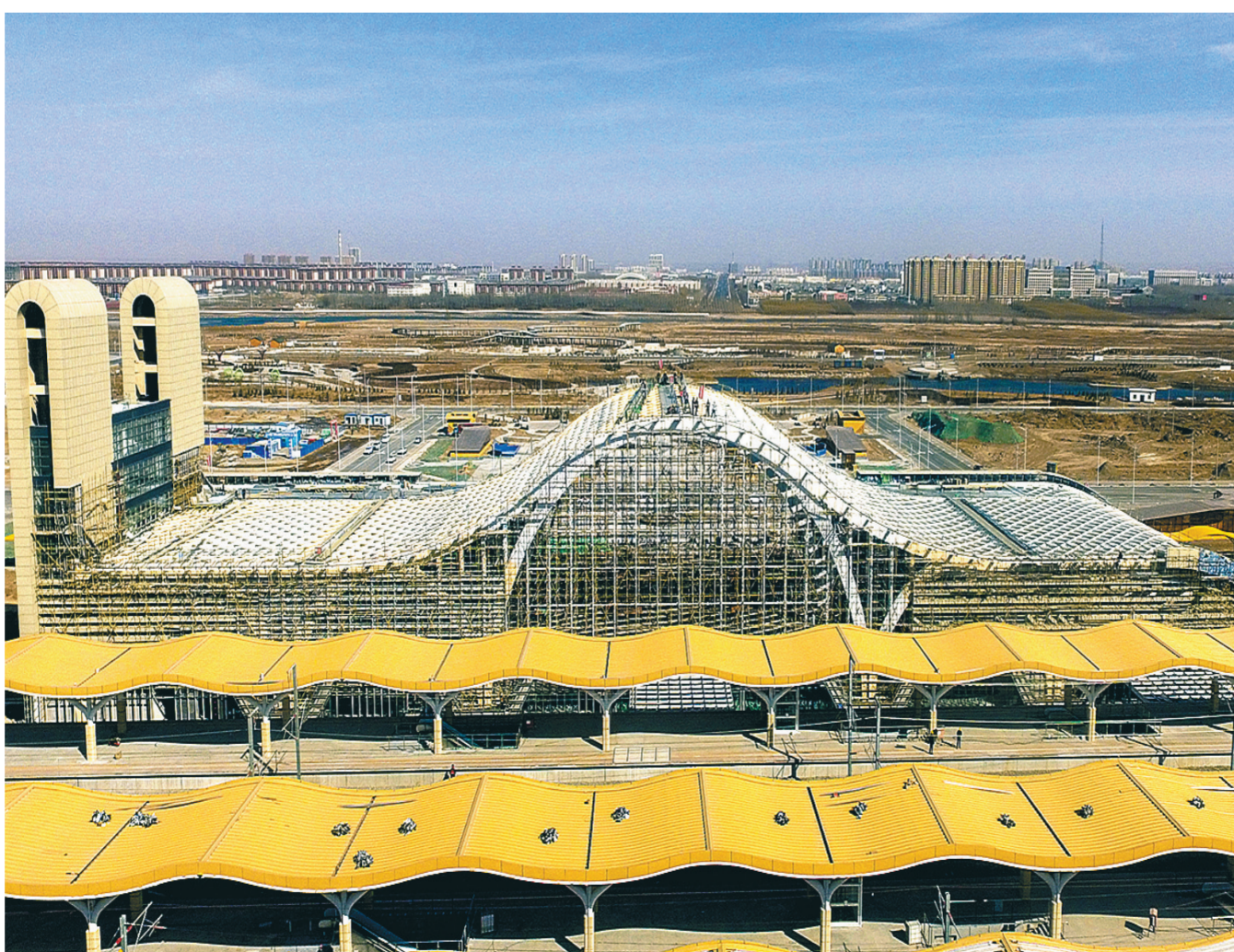
由中铁十六局承建的吴(忠)中(卫)城际铁路中卫南站,是宁夏回族自治区的首座大型钢结构车站。该车站站房主体面积达11843平方米,由12436个钢构件拼装而成。图为3月6日,完成主体结构施工的中卫南站。丁俊逸 摄
