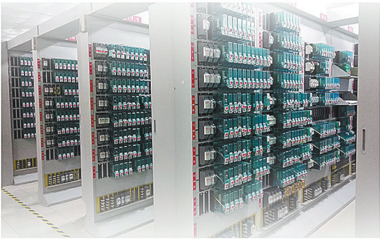
通信机房样板工程。
