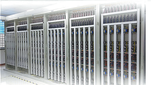
通信机械室综合布线。
