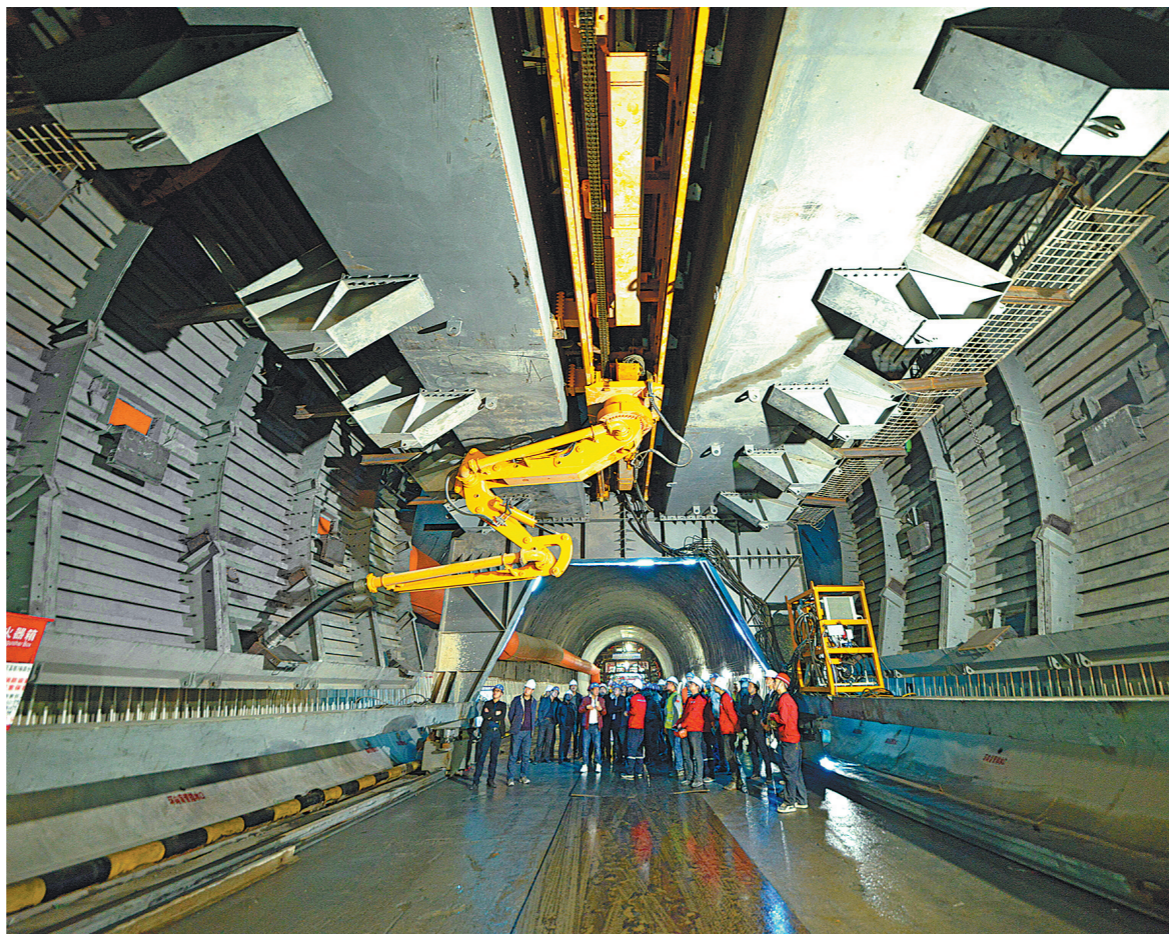
在郑万高铁湖北段罗家山隧道施工中,中铁十二局采用全电脑三臂凿岩台车、智能化二衬台车、三臂三筐拱架安装机等先进工装设备,并借助PMS信息化系统,大胆进行工艺革新和工法创新,多项研究课题填补了国内空白,提升了高铁隧道机械化施工水平。图为该隧道智能化施工引来观摩团。 景礼红 摄
