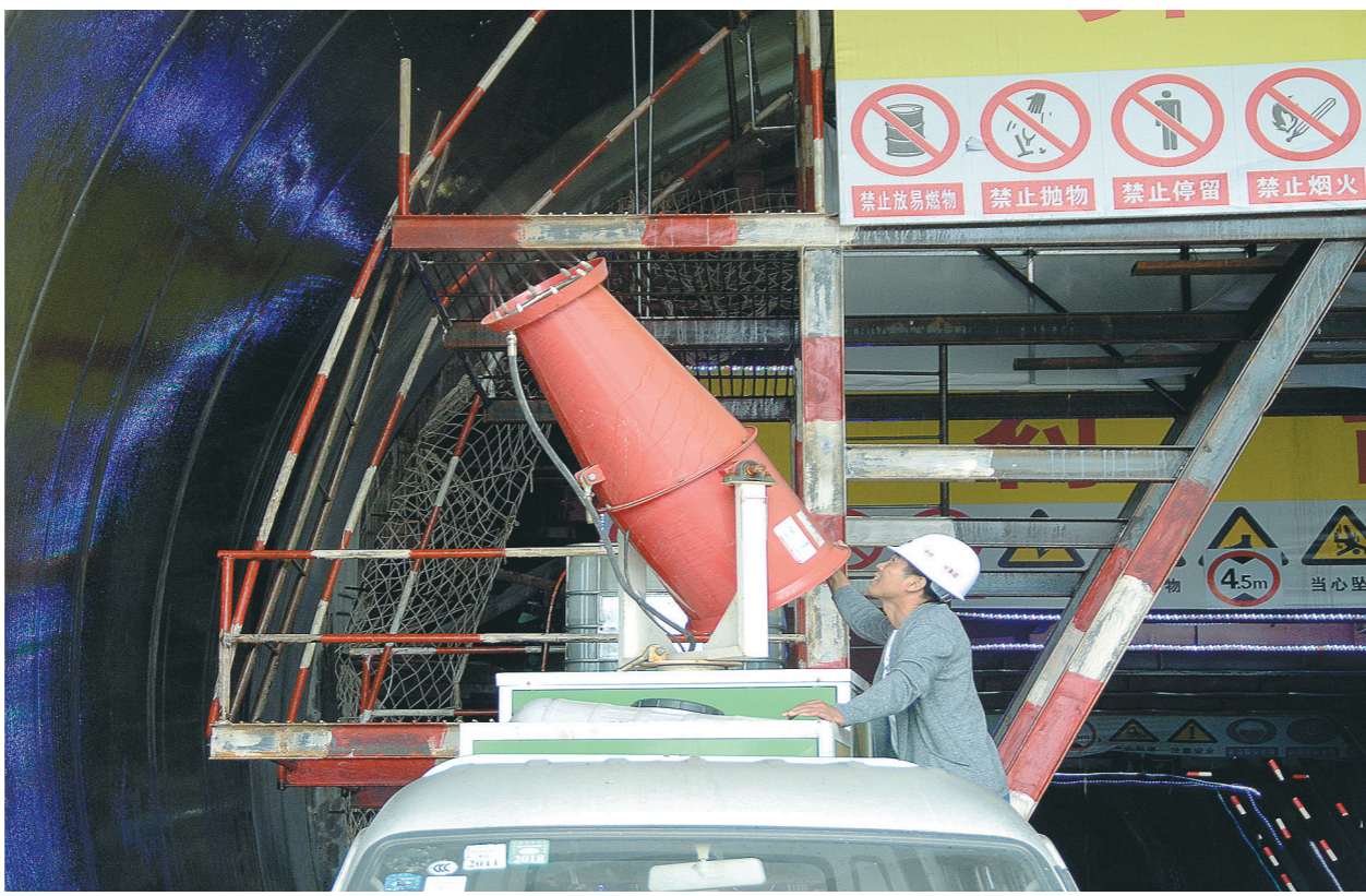
中铁十一局兴泉铁路项目部从加强现场管控和全面推广运用新技术、新工艺、新材料入手,把绿色环保理念贯穿铁路施工管理全过程,使桥梁桩基施工泥浆、隧道施工粉尘(灰)尘和路基(便道)裸露部位得到及时有效治理,在建设单位组织开展的信用评价中再次得到加分奖励。图为工人在峰岭隧道采用雾炮养护二衬混凝土。据悉,采用这种养护方式节约用水80%以上。 郑涛海 摄
