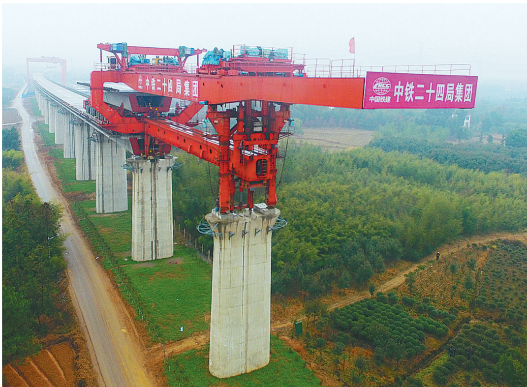
在商合杭高铁建设过程中,中铁二十四局践行“绿水青山就是金山银山”的环保理念,对配套弃渣场工程、梁场废水处理工程和附属边坡绿化工程实现全过程管控,严格落实环保各项要求和措施。图为该集团在商合杭高铁站前17标段架梁作业时,桥下已实现全面绿化的施工现场。黄植摄
