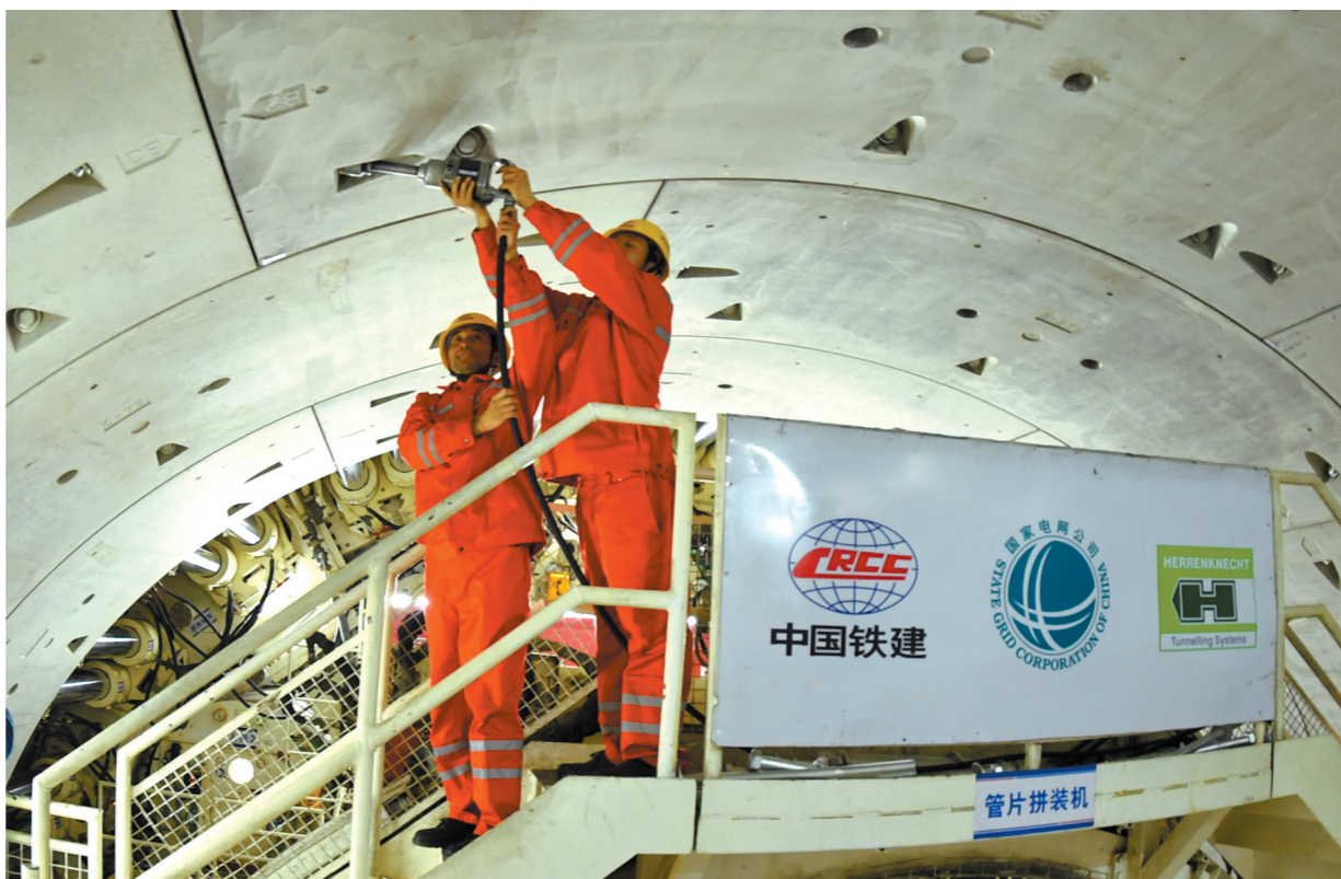
中铁十四局大盾构施工的苏通GIL综合管廊长江隧道,全长5.5公里,是目前穿越长江的最长隧道。现累计掘进超过3.3公里,掘进总里程占比60%,安全质量全面受控,受到业主贺电嘉奖。图为技术工人运输和安装管片。 刘福昌 摄
