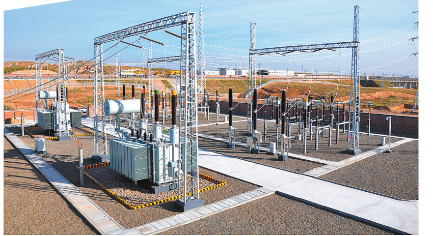
项目部承建的布尔陶亥牵引变电所
