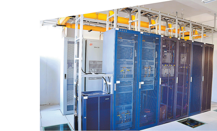
项目部承建的大院东通信机械室(全站样板工程)
