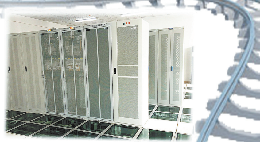
通信机房地下线缆分层架设
