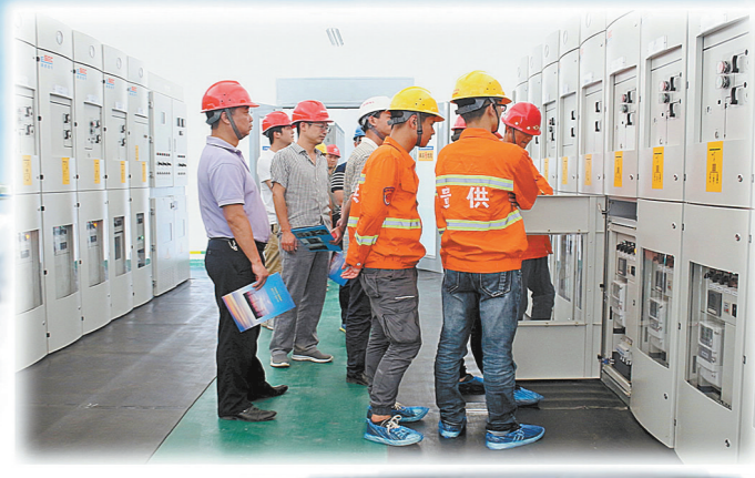
评估组对设备进行检查调试
