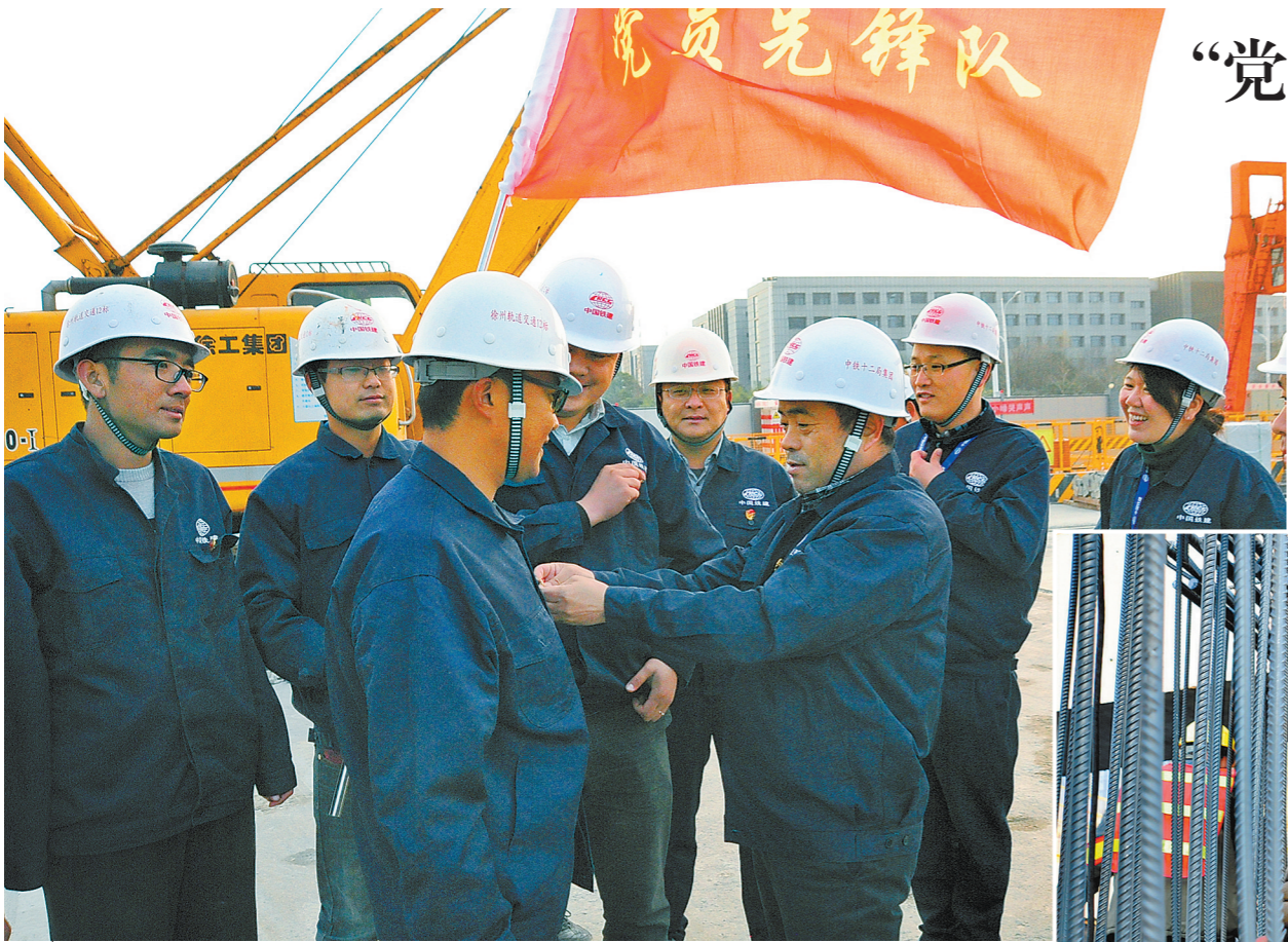
▲图为项目党工委副书记、项目经理王力功在为党员戴党徽。 ▶图为工人正在绑扎钢筋。
