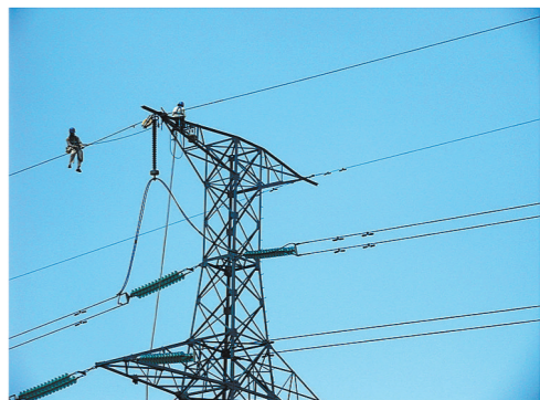
项目部把把危险系数较高的施工环节作为安全管理重点,严格把控,按流程操作,实现零事故。图为工人正在供电铁塔上作业。
